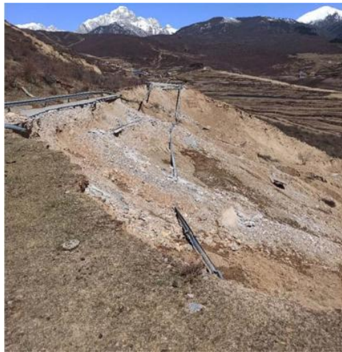
图3-1 现有公路垮塌处照片
